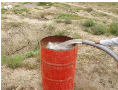
شکل ۱ - تصویری از پمپاژ آب زیرسطحی به منظور تعیین دبی جریان زیرسطحی در ساختگاه سدزیرزمینی
